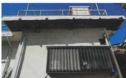
軒天井材の腐食落下(軽量鉄骨造)
