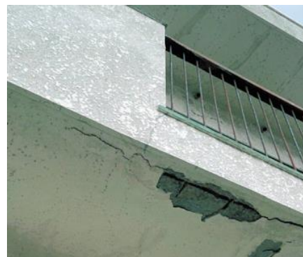
バルコニーの露筋 (RC造)
