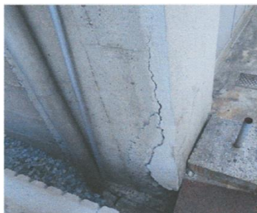
柱のひび割れ (RC造)
