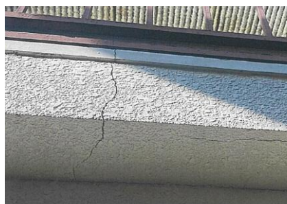
バルコニー軒先のひび割れ
