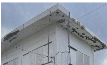
軒の剥落・露筋(RC造)
