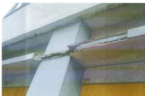
外壁の剥落 (RC造)
