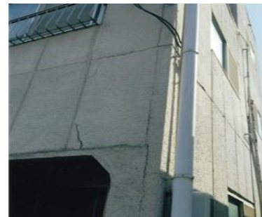
外壁 (ALC板) のひび割れ (鉄骨造)
