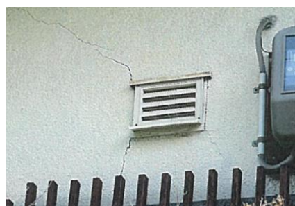
外壁のひび割れ
