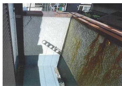
バルコニー腰壁のひび割れ・腐食
