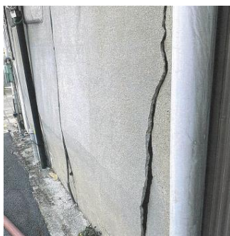
外壁のひび割れ・浮き
