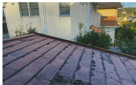
屋根材の腐朽(石綿セメント板)
