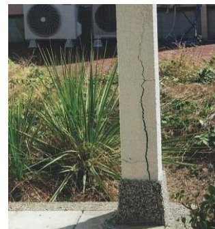
柱のひび割れ
