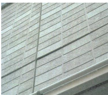
外装材の浮き
