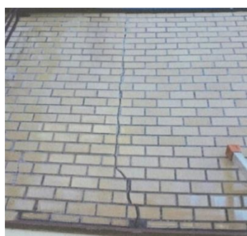
外壁タイルのひび割れ
