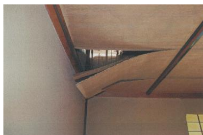
外壁破損による室内状況
