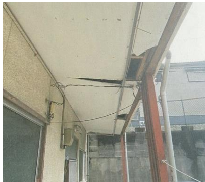
外廊下天井の剥落
