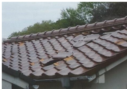
屋根瓦の剥落・ずれ
