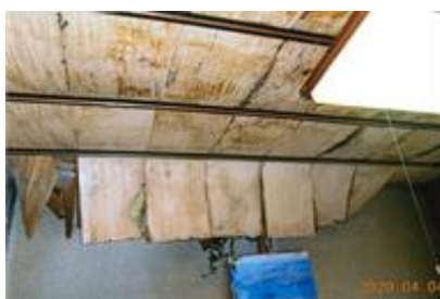
屋根破損による室内状況
