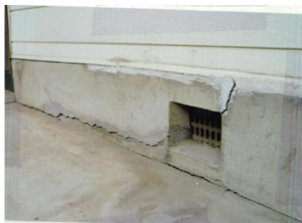
基礎のひび割れ
