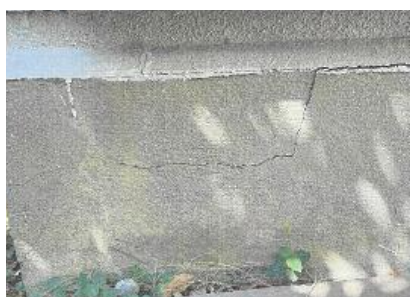
基礎のひび割れ
