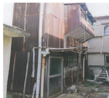
金属板の錆による腐朽
