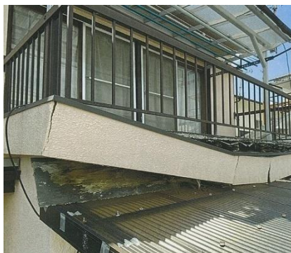
バルコニーの破損
