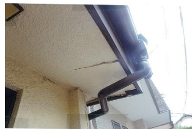
軒天井材のひび割れ
