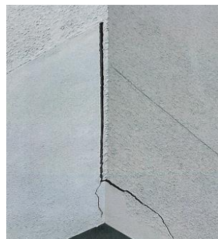
外壁のひび割れ
