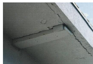
軒天井のひび割れ(軽量鉄骨造)
